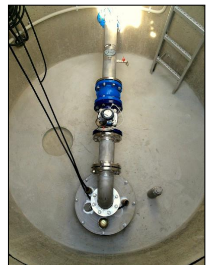
Fassung eines Brunnenschachtes mit Förderleitung und umgebendem Brunnenkopf
